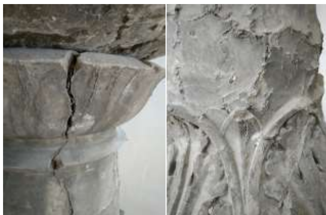
Рис. 6. Глибока тріщина на підставці хрестильниці та суцільна кірка новоутворень
